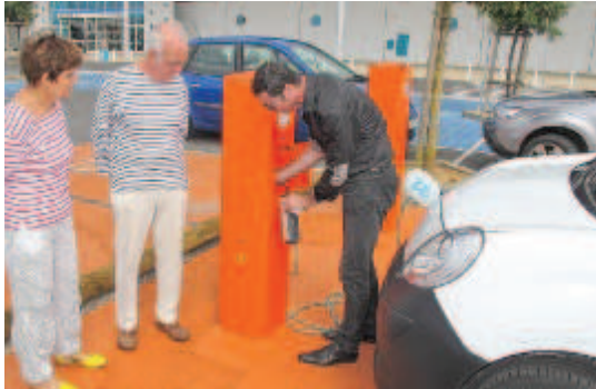
Plusieurs entreprises du département ont déjà joué le jeu de l'installation de bornes de recharges électriques.
